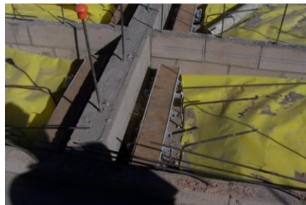
不正確的施作，鋼筋不均勻，防水未用膠帶。
