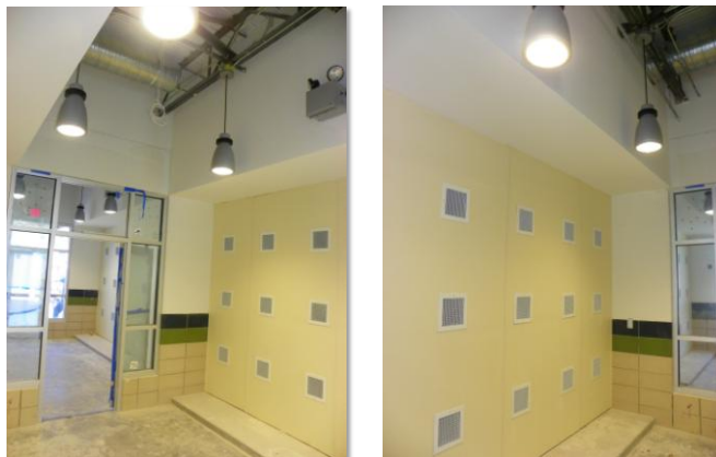
成排貓籠將會靠牆擺放，牆上已裝設通風系統
