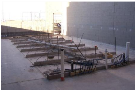
照片顯示，直立的鋼筋未受保護。
